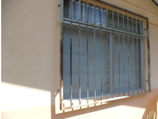
Fotografía 7 Reja Oxidada por corrosión-EBAIS SJM
