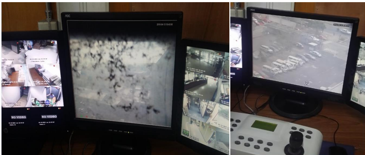
Figura 7: Área de Circuito Cerrado de T.V. y Monitoreo. Domos
