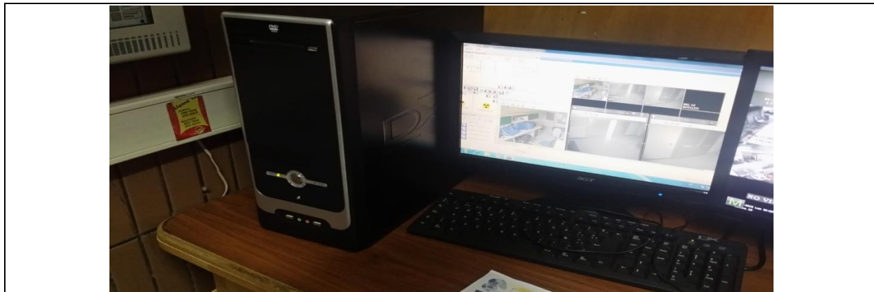
Figura 6: Área de Circuito Cerrado de T.V. y Monitoreo.
