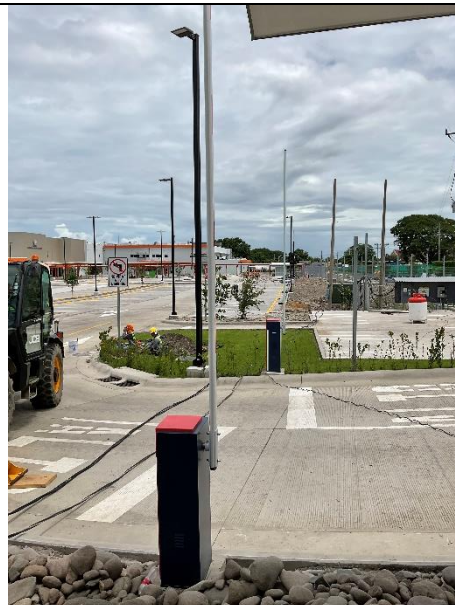
Fotografía 6: Detalle de aguja automatizada en entrada vehicular ubicada en el costado norte.
