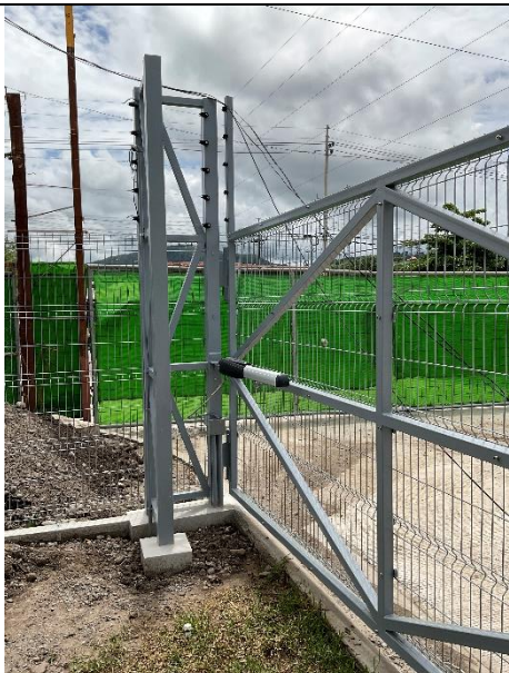
Fotografía 5: Detalle de porton vehicular con cerca electrificada de 5 hilos y motor electrico de pistones.
