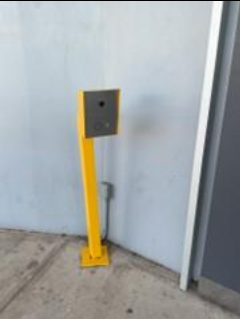
Fotografía 11: Intercomunicador con cámara ubicado en la entrada de Sala de Choque del Servicio de Emergencias en el Módulo 1.
