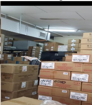
Conducto de aire acondicionado
