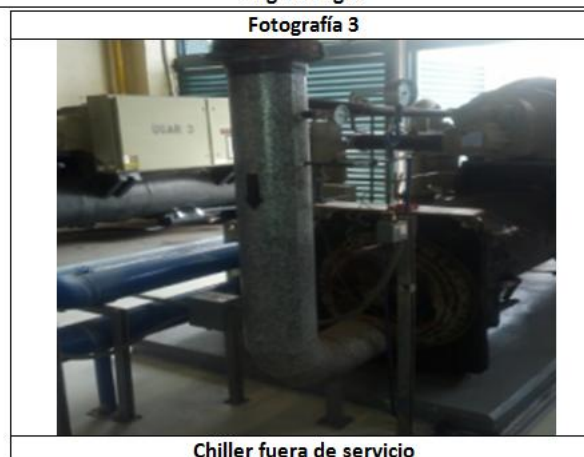
Chiller fuera de servicio
