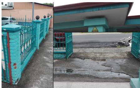
Humedad y acumulación de agua
