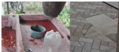
Pila con acumulación de agua y piso con cerámica desprendida.
