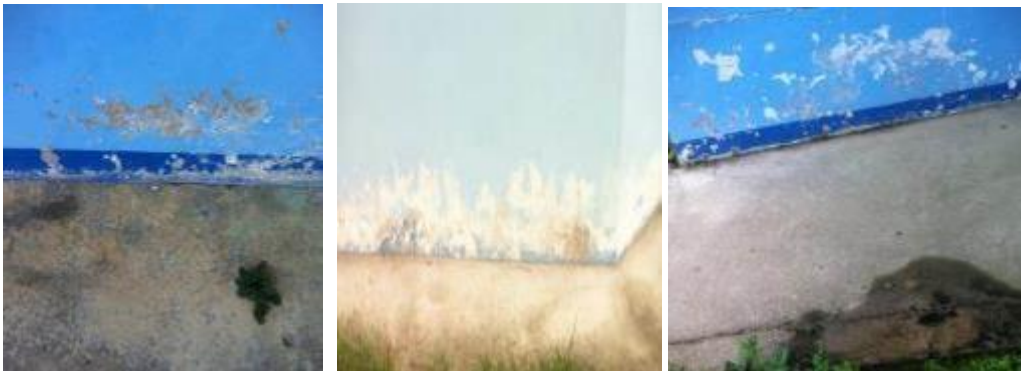
Desprendimiento de pintura en paredes.
