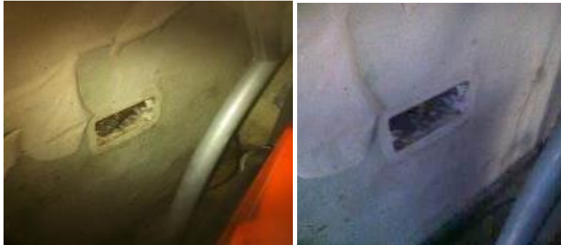
Orificios en paredes por falta de tomacorrientes
