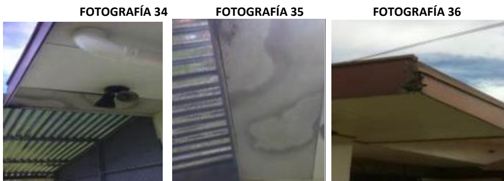
Lámparas sin bombillos, manchas en cielo raso y precintas dañadas
