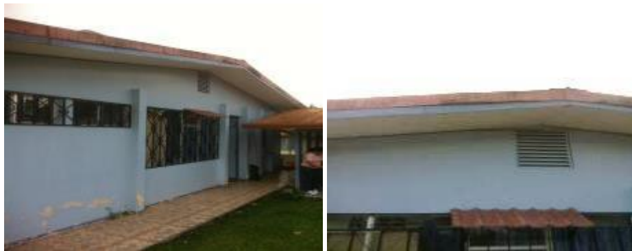
Precintas sucias y oxidadas
