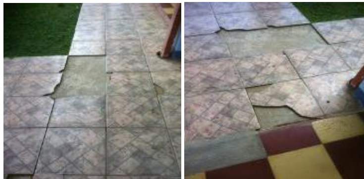
DESPRENDIMIENTO DE CERÁMICA DEL PISO
