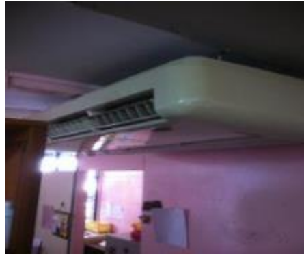
Aire acondicionado dañado
