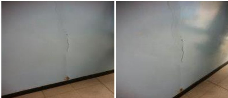
Paredes con grietas
