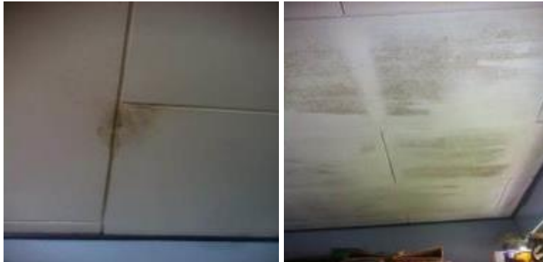
Daños en cielo raso por filtraciones y exceso de suciedad.
