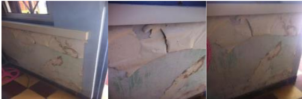
Paredes con daños en la pintura
