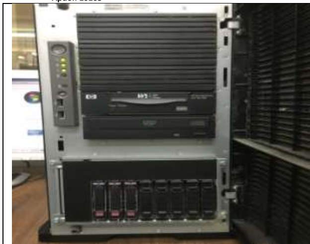
Gabinete principal de telecomunicaciones
