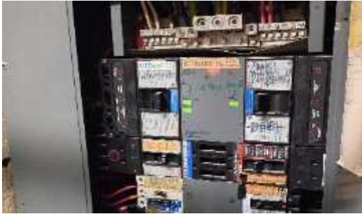
Repuestos electricos que carecen de distribución en el mercado y hacinamiento
