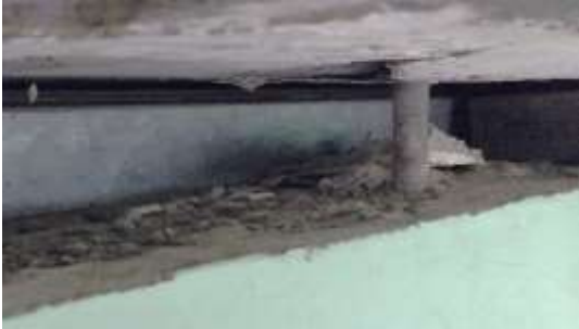
Separación de pared del elemento horizontal con varillas expuestas
