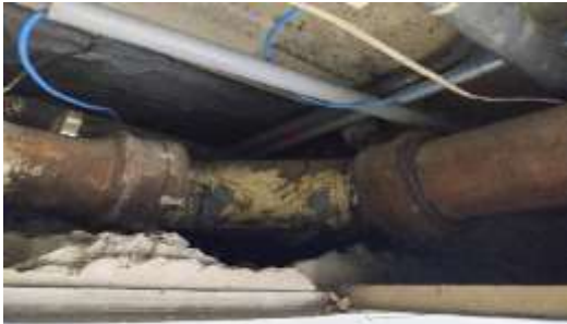
Tubería de metal de aguas negras desgastada y en mal estado
