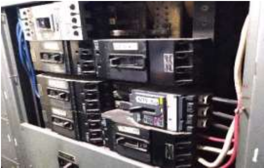
Repuestos electricos que carecen de distribución en el mercado
