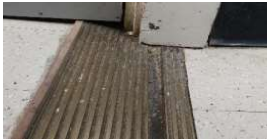
Grada en piso en junta entre estructuras que antes estaban a nivel
