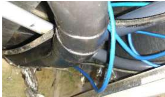
Aglomeración de tuberías y cableados
