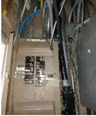
Hacinamiento de tuberías y cableado
