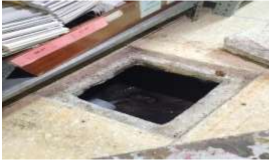
Problemas de rebalse caja registro aguas negras
