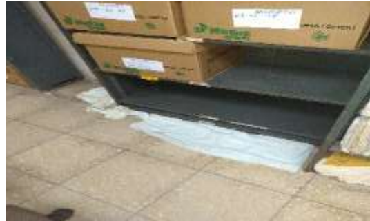
Toallas en el piso por problemas de inundación
