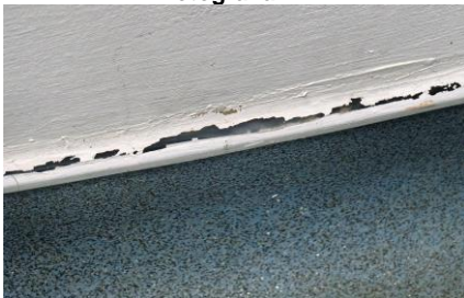
Desprendimiento de pintura en curva aséptica
