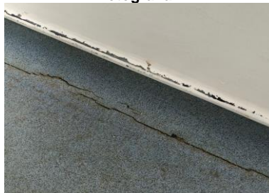
Fisuras en curva aséptica
