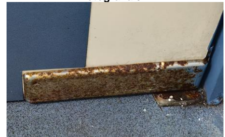
Bisagra interna inferior de puerta oxidada
