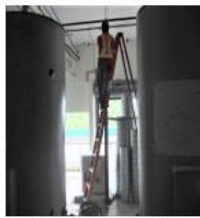
Tanques agua caliente
